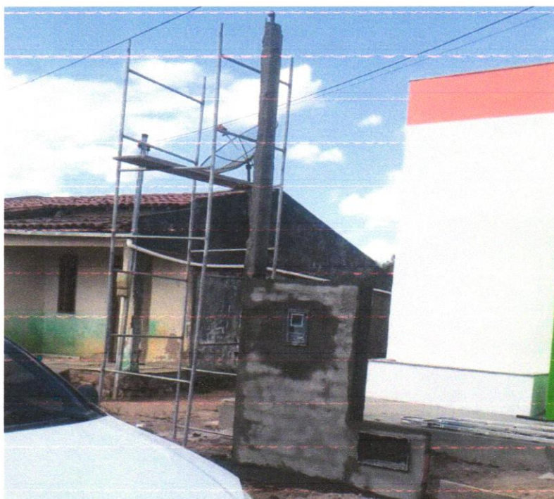
FOTO 01 – (COMPOSIÇÃO REPRESENTATIVA) EXECUÇÃO DE ESTRUTURAS DE CONCRETO ARMADO, PARA EDIFICAÇÃO HABITACIONAL UNIFAMILIAR TÉRREA (CASA EM EMPREENDIMENTOS), FCK = 25 MPA. AF_01/2017
