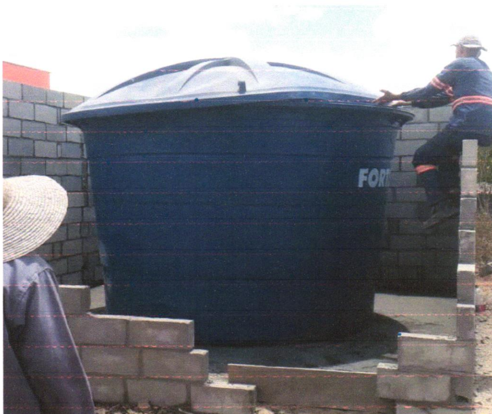
Foto 05 - RESERVATÓRIO DE POLIETILENO 10.000 LITROS
